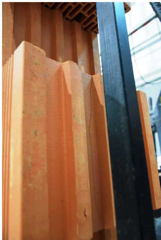
Slika A6: Anomalijska razpoka na desni strani druge vrste - na tem mestu ni napetosti.
