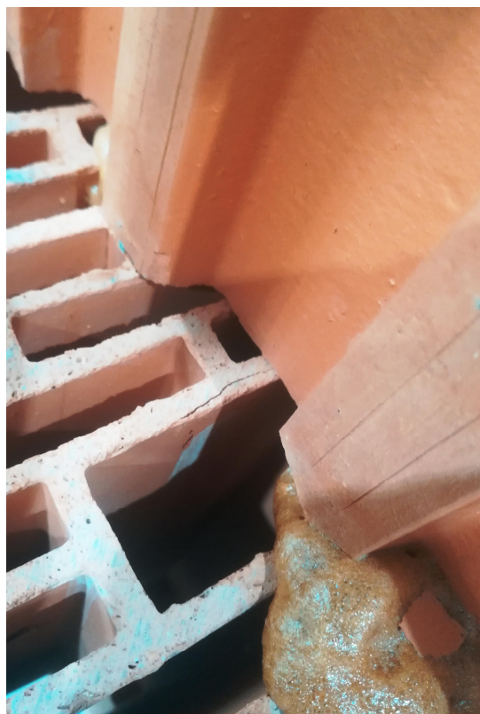
Slika A9: Opažena razpoka v rebro zidaka pred pričetkom preskusa - druga vrsta, leva stran.
